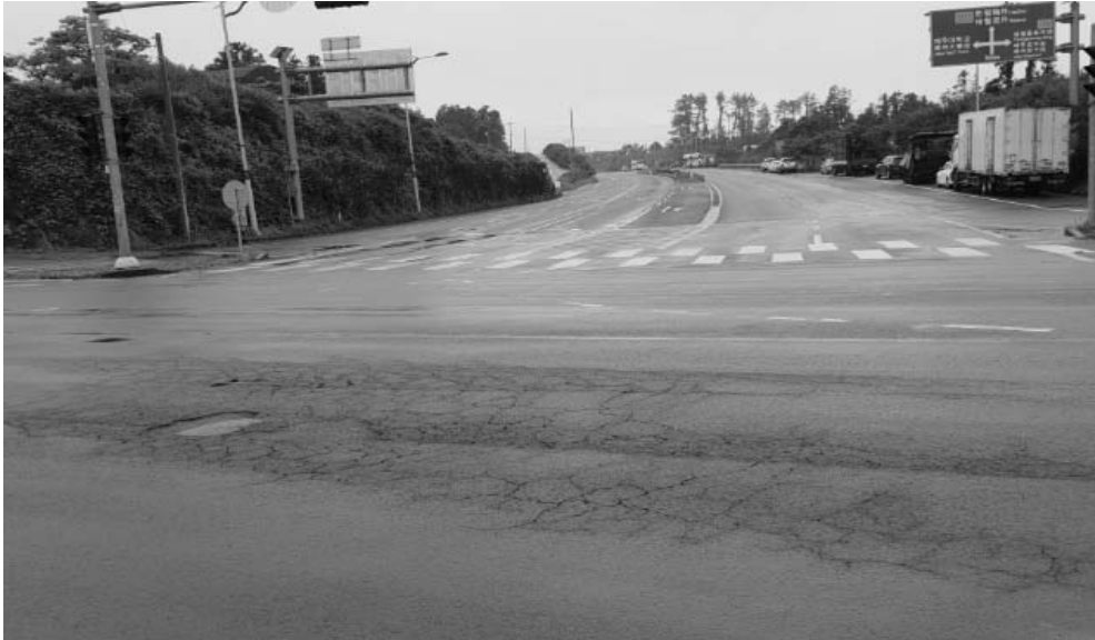
[그림 11] 제주시 영평동 도로에 생긴 포트홀
