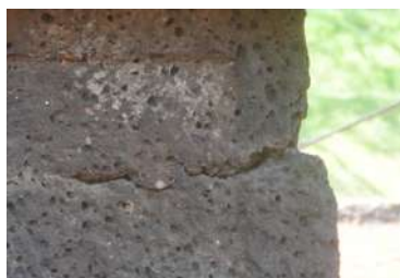
기단부 균열 및 마모
