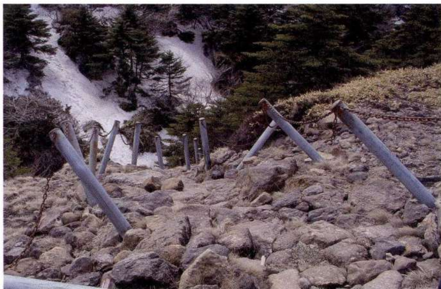
사진 3-9.보호책 시설이 파괴된 서북벽등산로
